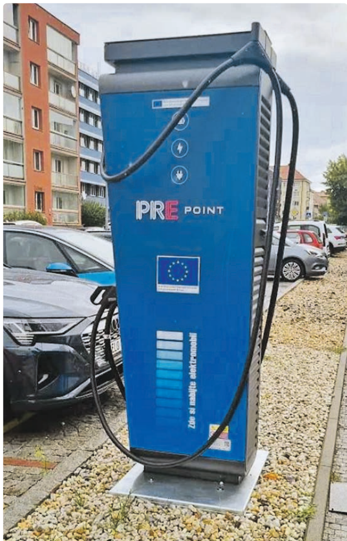
Nová ultrarychlá dobíjecí stanice pro elektromobily v Praze 10 ulici Na Hroudě.
