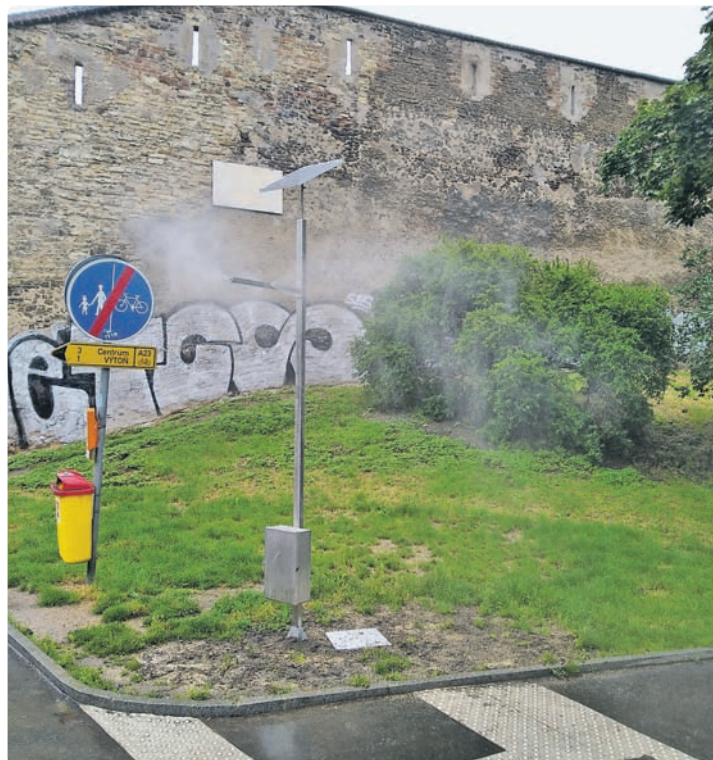
Většina mlhovišť je vybavena solárním panelem a termostatem, který reguluje jejich činnost podle venkovní teploty.
