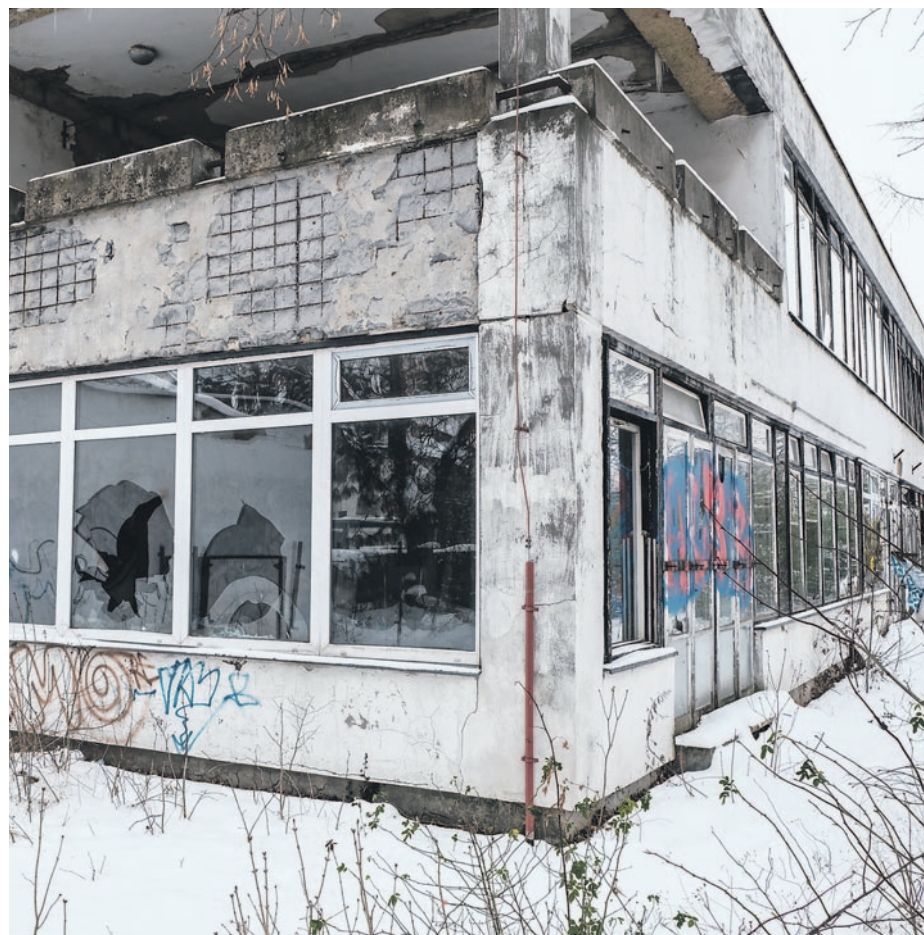
Bývalá školka v ulici Nad Ondřejovem je problémovým objektem.
